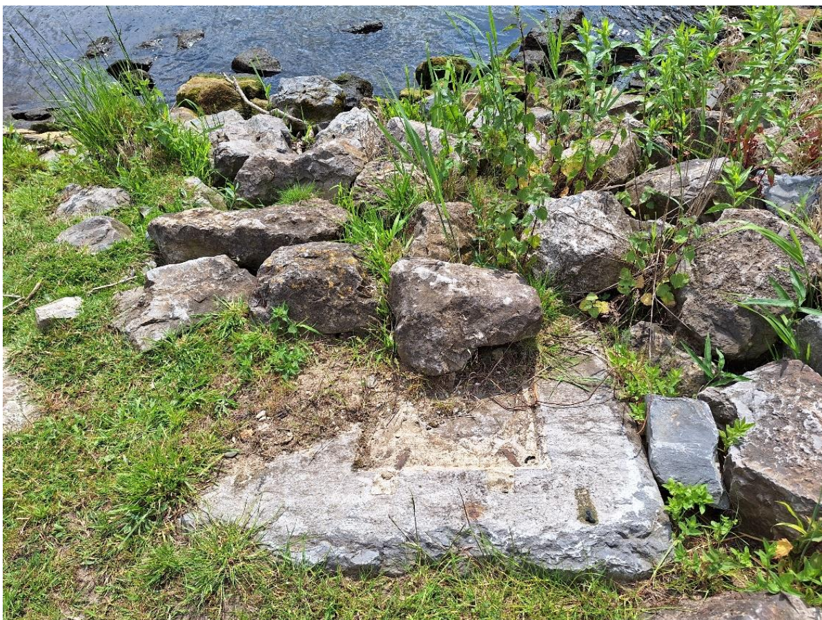
Steen in oevertalud, rechteroever nabij pijler fietsbrug.
